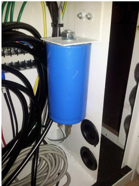
Condensator van de fan
